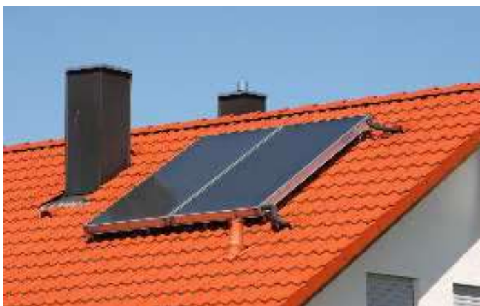
Exemple d'installation solaire individuelle
