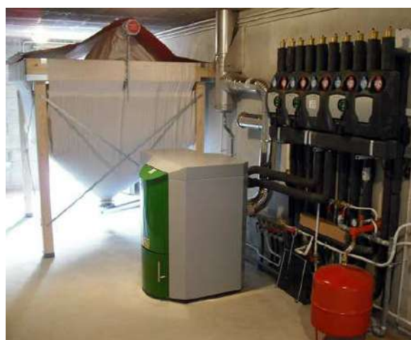
Chaudière à granulés
